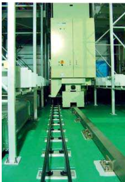
● Многоярусный склад в чистом производственном помещении
